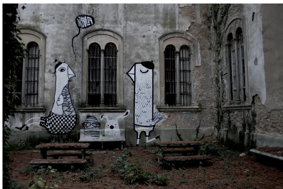
Fig. 13 - Ospedale psichiatrico di S. Girolamo, Volterra. Pitture murali di ricoverati in stato di degrado.
