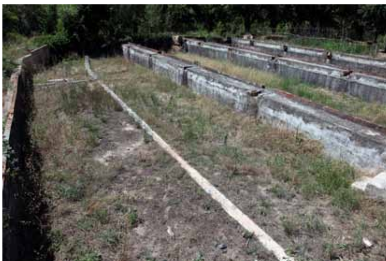
Figura 3.1.8. Restes de la piscifactoria de truita del Molí d'en Fort, al riu Brugent (Farena, Mont-ral) destruïda per l'aiguat de 1994.
