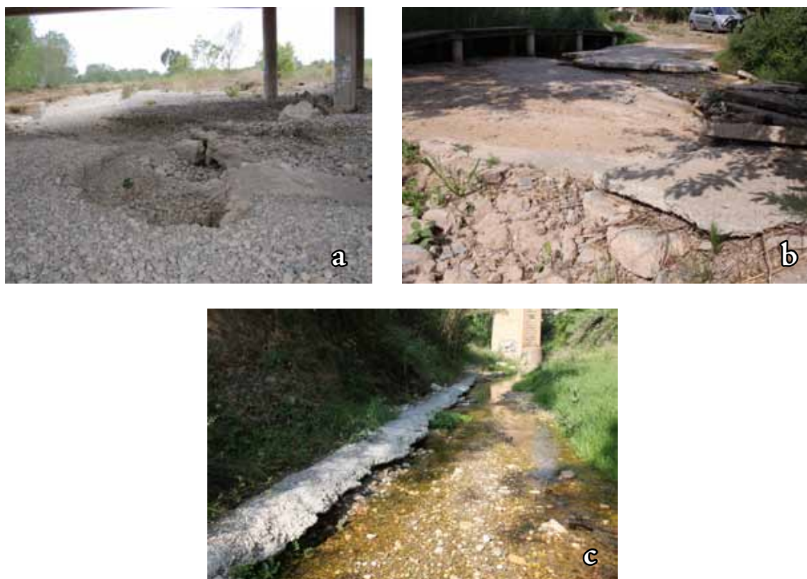
Figura 3.2.10. Pilars desfalcats del pont de l'autovia del Mediterrani (A-7) a Tarragona (a), gual de formigó al riu Glorieta a Alcover (b) i canonada al torrent del Catllar a Valls (c).
